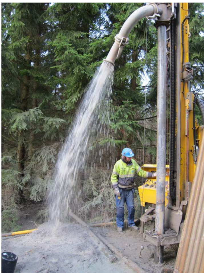
Figur 9. Den rigg som används för borrning är både stor och tung. Det är viktigt för entreprenören att iakttä försiktighet för att minimera skadorna, särskilt på känslig mark. Det är också viktigt att hålla utrustningen i gott skick för att förhindra läckage av olja eller diesel.
